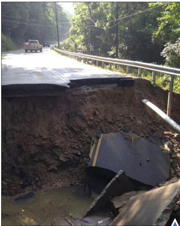
خرابی پس از سیل؛ کلندین، ویرجینیای غربی
